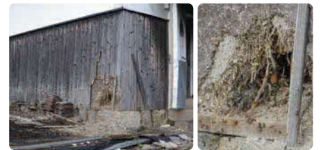
ハチの巣を狙って壊された建物
