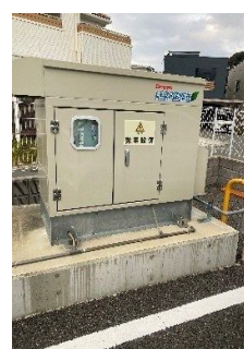
非常用発電装置
