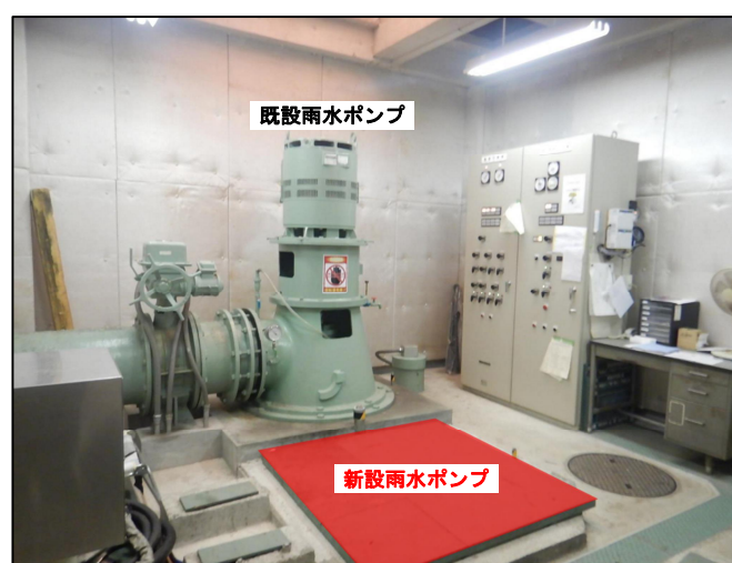
早時排水区の雨水ポンプ増設
