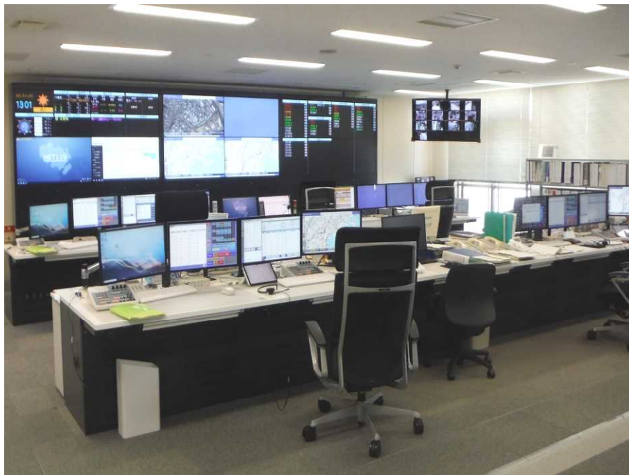
高機能消防指令センター
