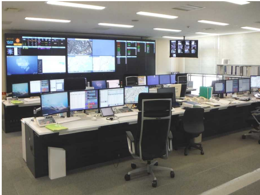
高機能消防指令センター
