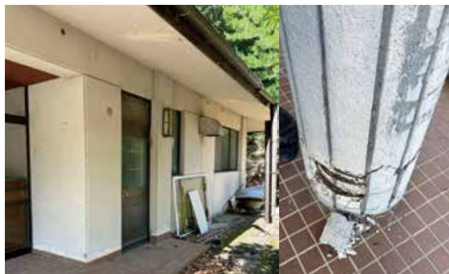
老朽化した設備
