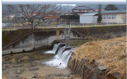
農業用水路の整備の例（浅原地区ゲート）
