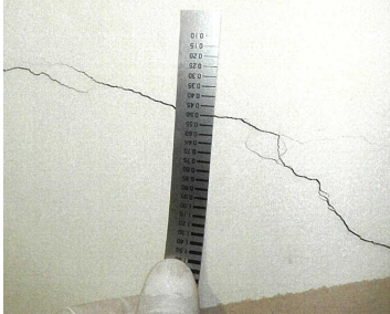
建物のひび割れ
