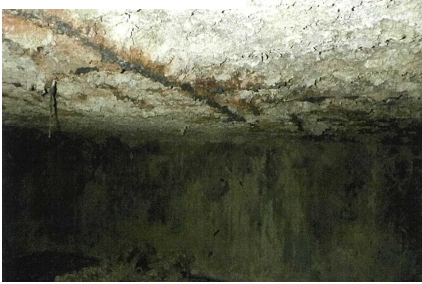
貯留槽の腐食
