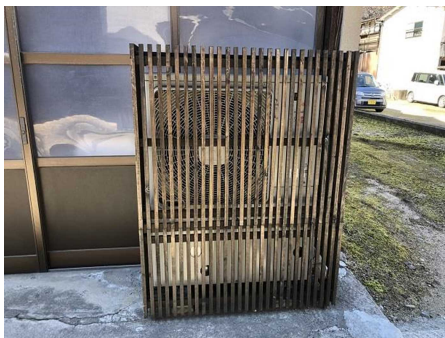
目立たない配慮がなされた空調室外機
