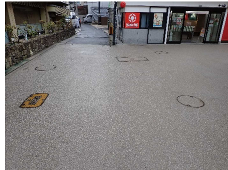
マンホール類
