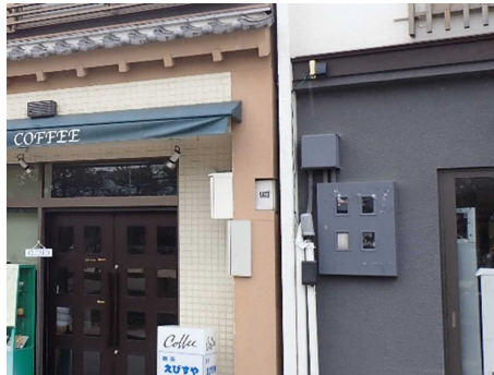
現しで設置されたメーター
