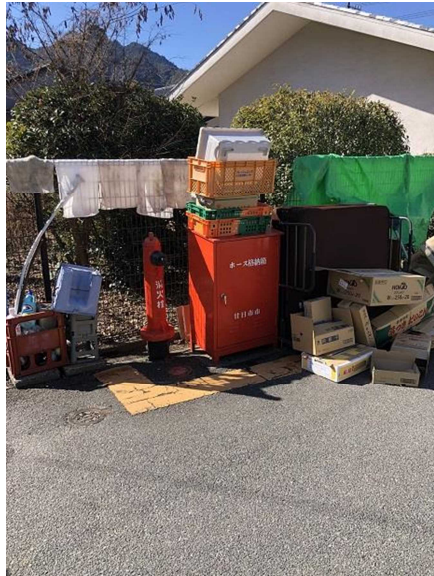
消火栓とホース収納箱
