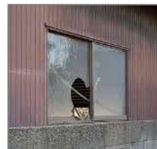
窓が割れた管理不全空家
