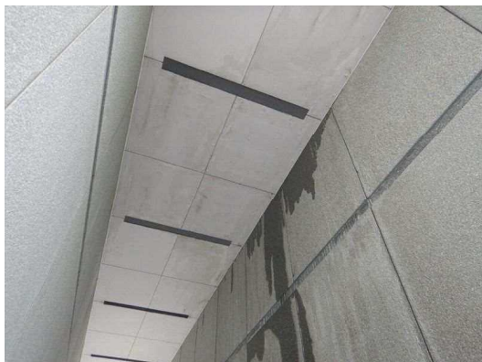
1階ピロティ部の軒天からの漏水
