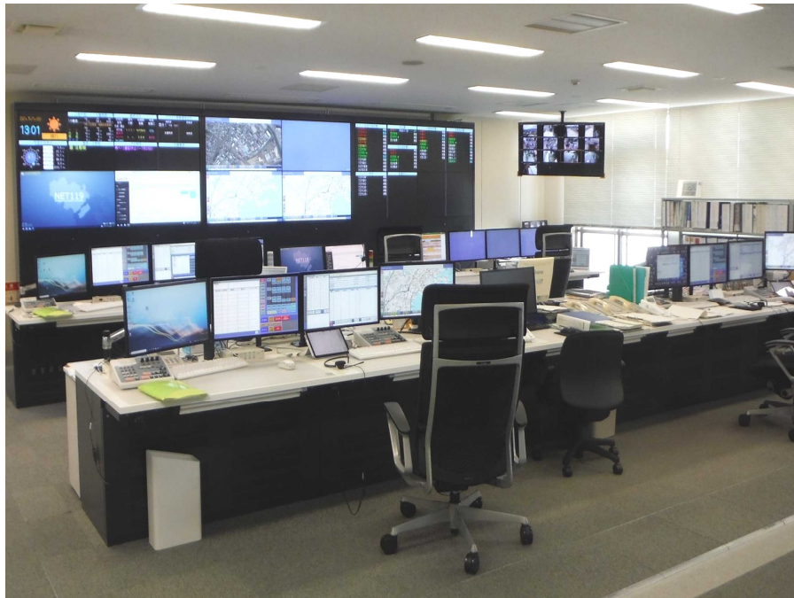
高機能消防指令センター
