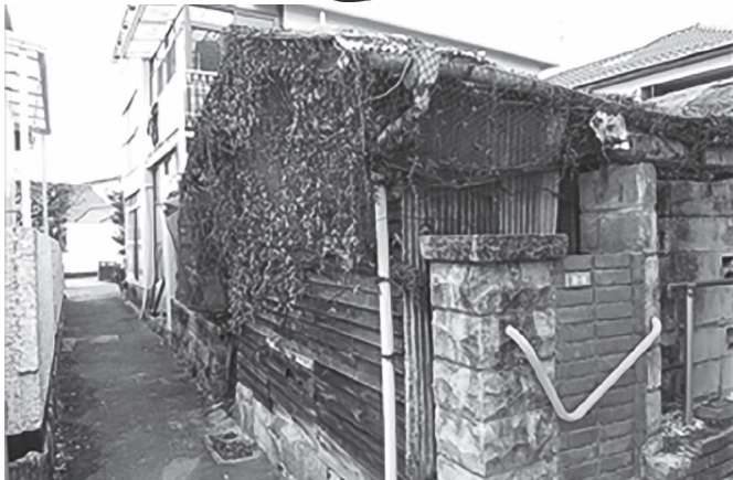
▲瓦や壁が一部崩れた状態で放置されている。隣人や通行人の身に危険を及ぼしかねない
