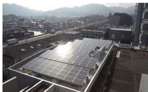
▲庁舎に導入された太陽光発電
