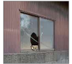
窓が割れた管理不全空家
