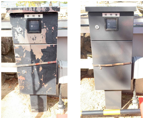
分電盤の塗装
