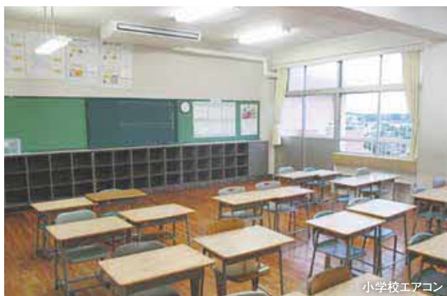
小学校エアコン
