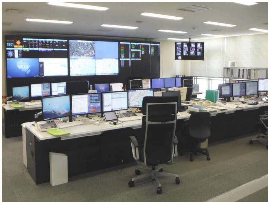
高機能消防指令センター
