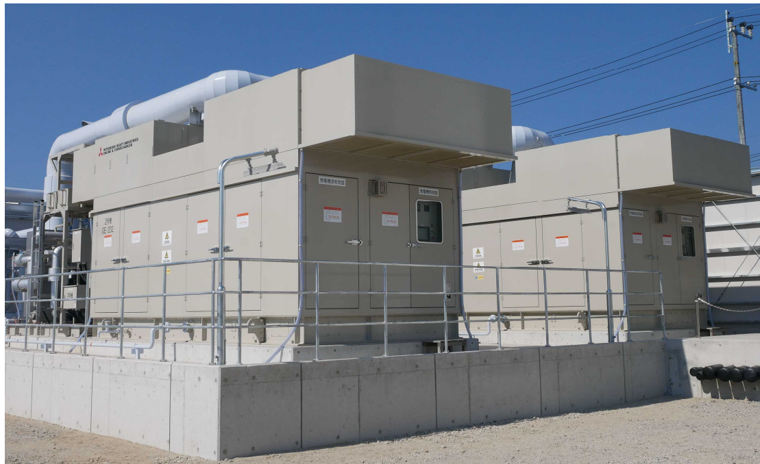
新設されたガスコージェネレーションシステム（広島ガス廿日市工場）
