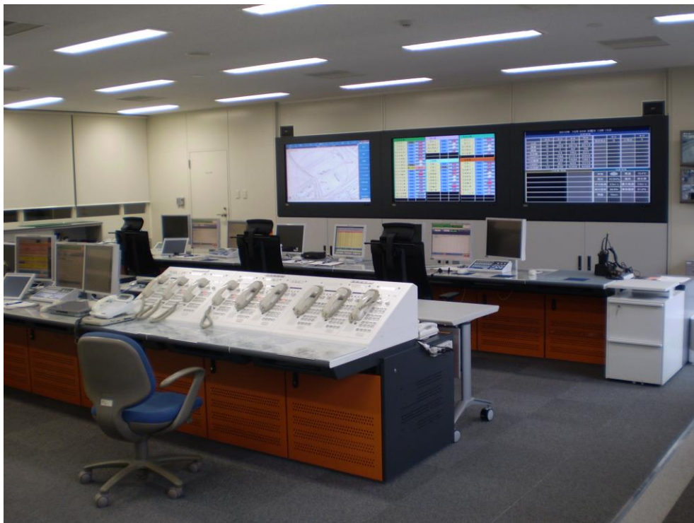
高機能消防指令センター
