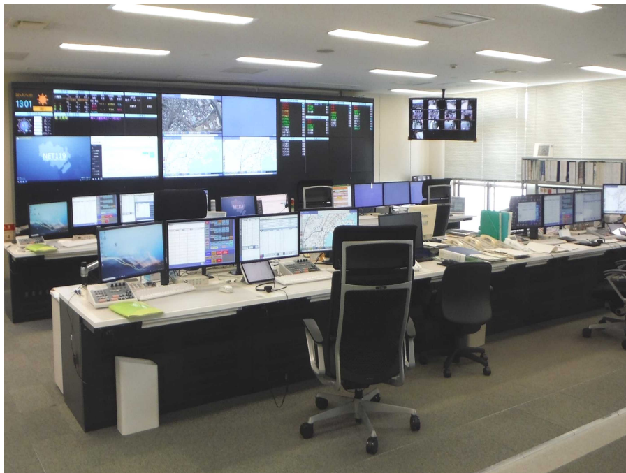
高機能消防指令センター
