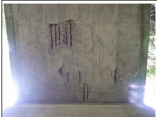
床版の腐食(コンクリート床版)
