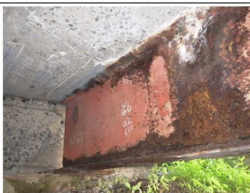
主桁の腐食(鋼桁)
