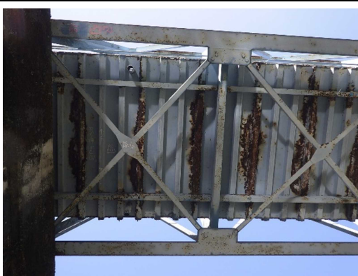
床版の腐食(鋼床版)
