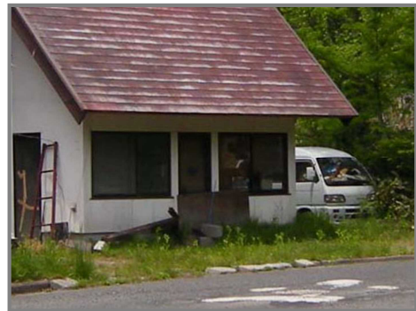
老朽化し管理が行き届いていない 別荘の建物
