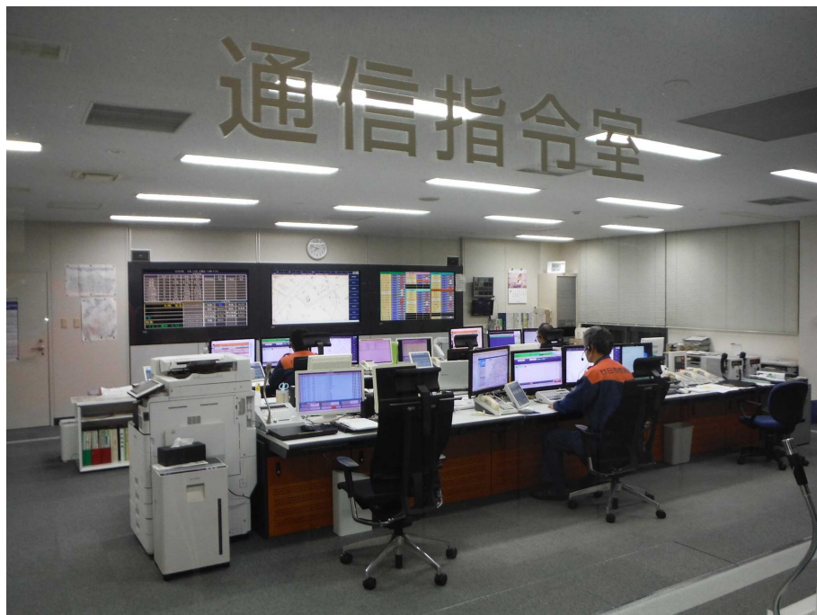
高機能消防指令センター
