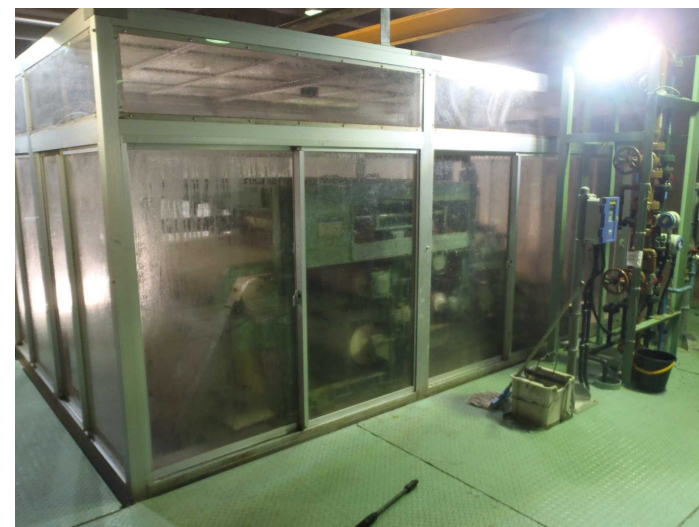
更新する平成6年供用開始の脱水機（1号機）
