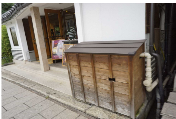
室外機を外壁意匠と調和させた事例
