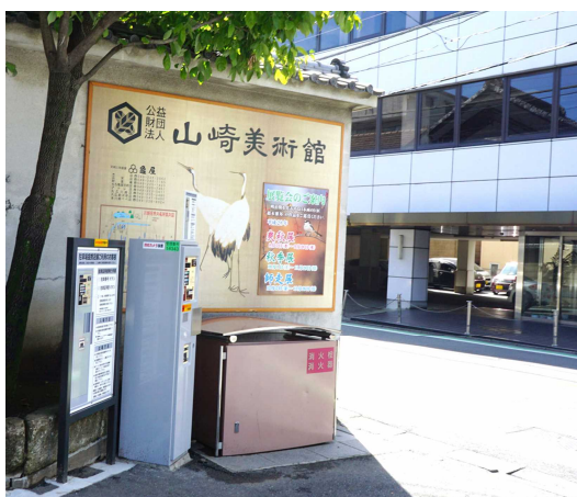
消火栓の化粧事例
